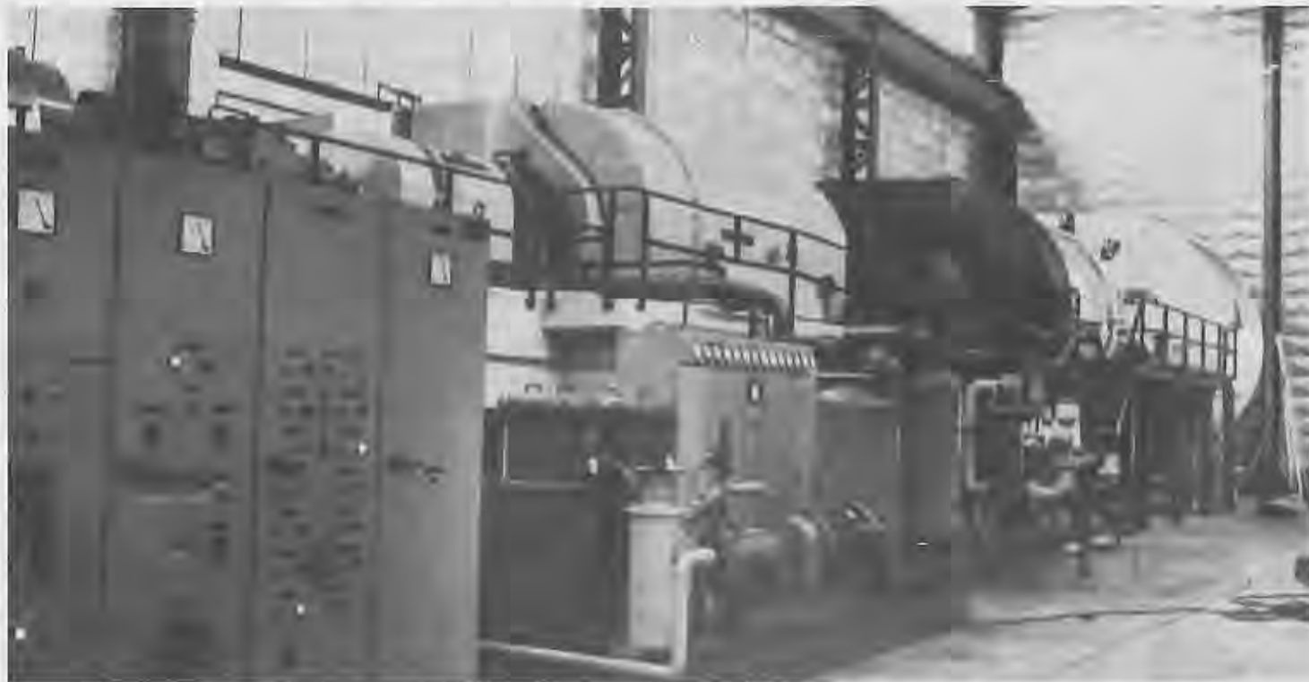
Este es el turboalternador FIAT TG-25 de 30.000 kilowatt, instalado en la subestación Dock-Sur de la compañía SEGBA. Su función principal es alimentar las barras de alta tensión de la subestación, de 132.000 W. Las dimensiones del TG-25 son: largo, 12.500 mm; ancho, 4.500 mm; y alto, 5.200 mm. Su peso alcanza las 120 toneladas
